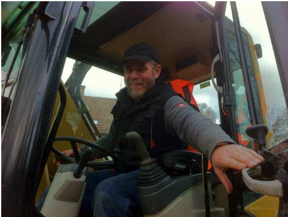
Der Baggerfahrer: Ein Meister seines Faches! Selten war die Grube für den Eisspeicher so perfekt ausgehoben.
